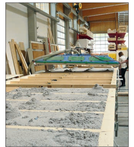
Bevorzugt diffusionsoffene Bauweise: Gefachdämmung mit Zellstoff per Flockplatte bei Bruno Kaiser in Bernau
